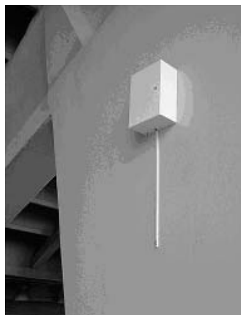
Рисунок 4. Датчик ВКВ-2 на опорі другого ярусу трибун
